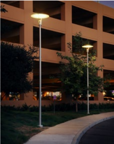
OL1 - Pole light fixture
